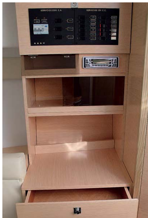
En la banda de estribor se ha instalado un armario para las radios.
