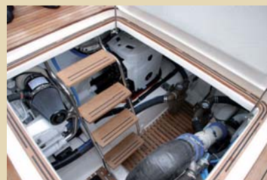
El acceso a la sala de máquinas se realiza a través de una tapa en el plan de la bañera. Una sólida escalera facilita el descenso.
